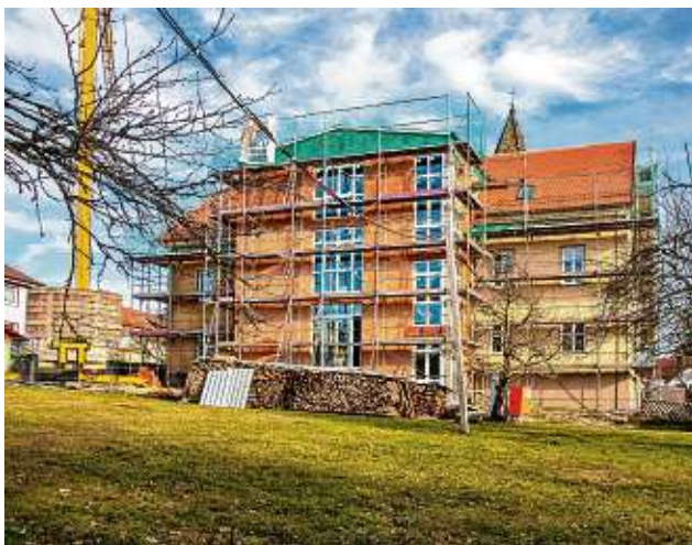
Der neue Anbau mit Fahrstuhl und Treppenhaus soll sich harmonisch in das Erscheinungsbild des historischen Rathauses einfügen.
