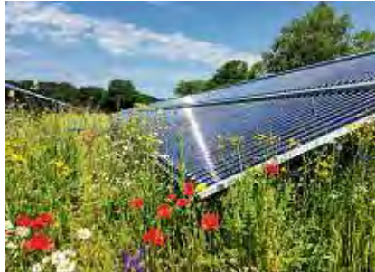
Solche Solarthermie-Kollektoren würden auch in Thalheim eingesetzt werden. Das Bild zeigt eine Anlage in Randegg im Kreis Konstanz. BILD: JÖRG DÜRR-PUCHER
