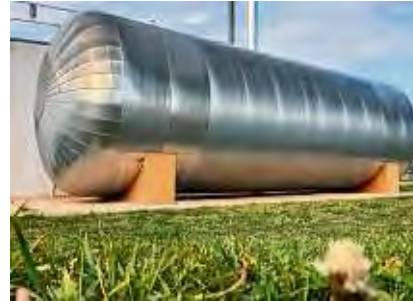
So ein Pufferspeicher, wie hier in Leibertingen, könnte auch bald in Thalheim stehen. Er erhöht die Versorgungssicherheit im Nahwärmenetz. BILD: HEINRICH STURM
