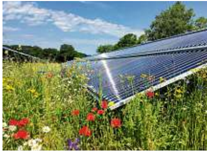
Solche Solarthermie-Kollektoren würden auch in Thalheim eingesetzt werden. Das Bild zeigt eine Anlage in Randegg im Kreis Konstanz. BILD: JÖRG DÜRR-PUCHER
