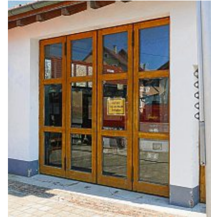
Die Altheimer Feuerwehr muss das Tor zum Gerätehaus in der Höhe anpassen.
