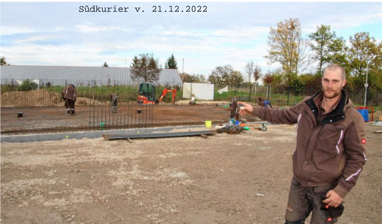
Der junge Bauunternehmer Lukas Glöckler steht Anfang November auf seinem Firmengrundstück im Meßkircher Industriepark. Zum Zeitpunkt der Aufnahme wurde gerade die Eisenarmierung für die Grundplatte der neuen Halle vorbereitet. BILD: MANFRED DIETERLE-JÖCHLE
